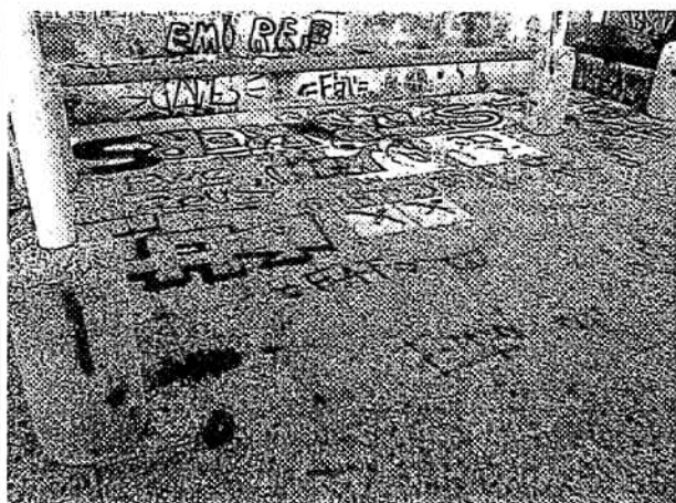
Un'immagine del degrado della sovrapietra del porto
